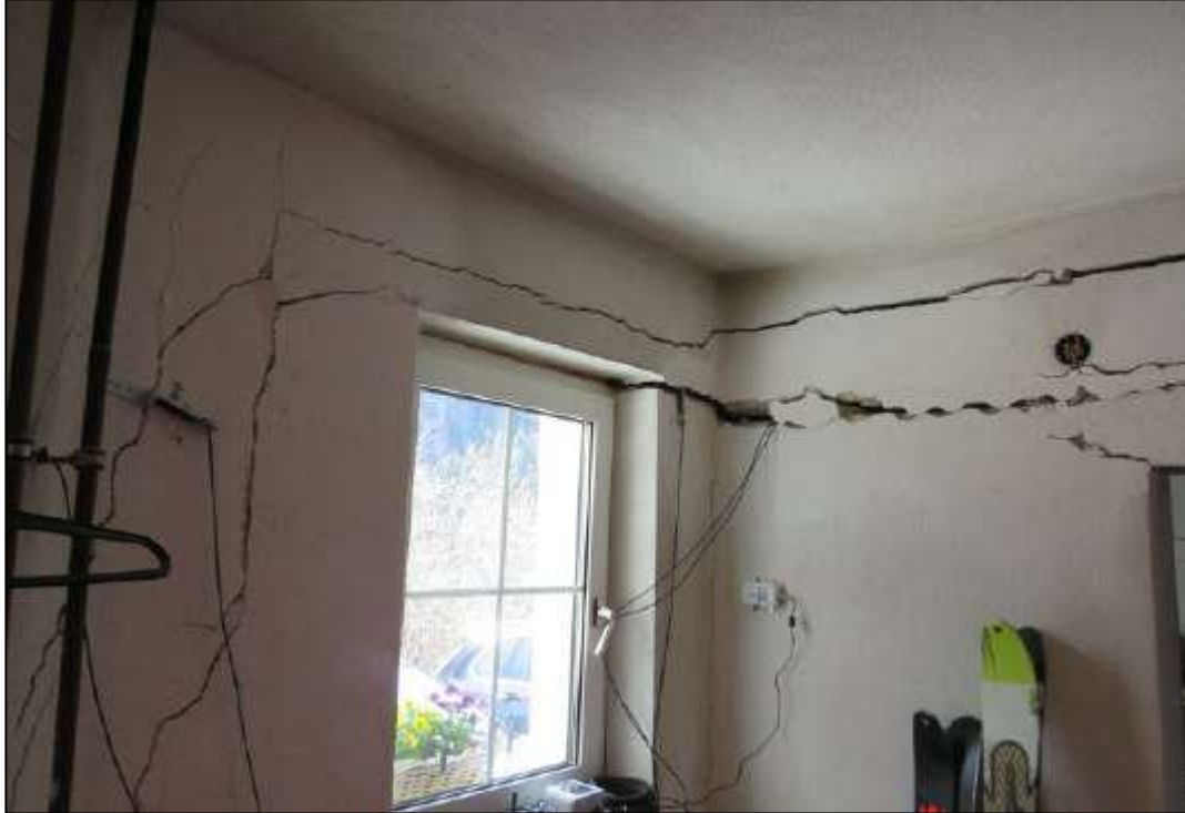
Bild 3: Risse KG mit Überwachungssystem
