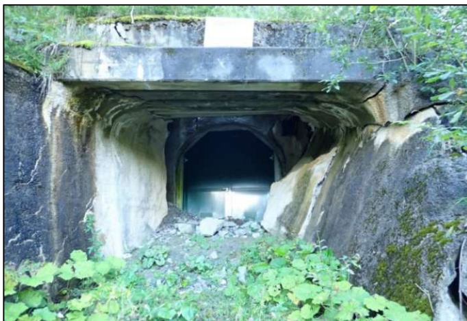
Abb. 14. Portal mit den beschädigten Luftbögen 2019.
