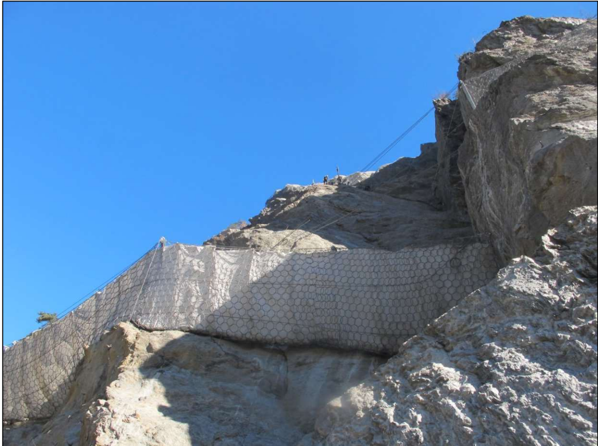
Abbildung 16: Steinschlagnetze im Bereich der hohen nördlichen Felswände
