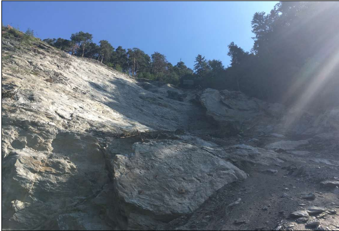
Abbildung 14: Abbruchfläche endet ca. 10 m oberhalb der Straße
