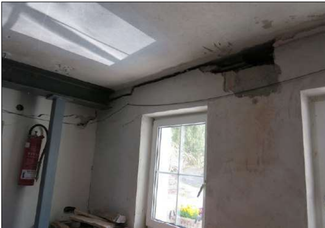
Bild 4: Riss durch das Kellergeschoss
