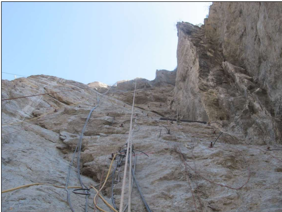
Abbildung 15: nördlicher Pfeiler, Verankerung von Felsplatten und des Kopfes des darunter befindlichen Keilausbruches
